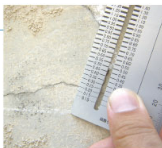
クラックスケールによるひび割れの測定
